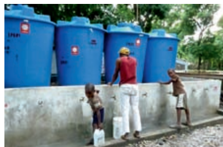
Wasserversorgung in den Lagern der Obdachlosen. Die Bereitstellung von sicherem Trinkwasser ist die wichtigste Maßnahme gegen eine Choleraepidemie.
